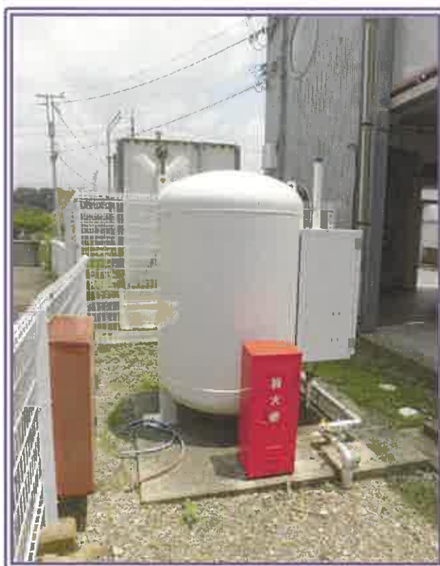
エントランス脇の供給設備（手前のLPガスタンクと奥の貯水タンク）
