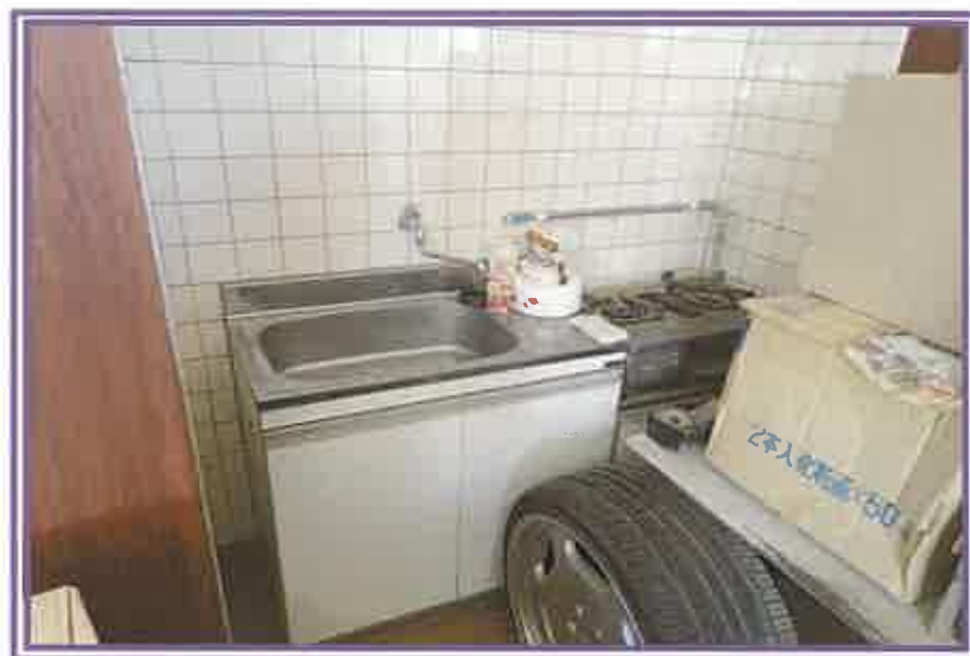
事務所に設置されている流し台を撮影したもの(物件2)
