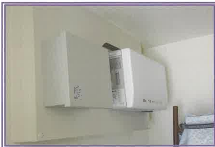
パワーコンディショナー及びその周辺を撮影したもの(物件3)
