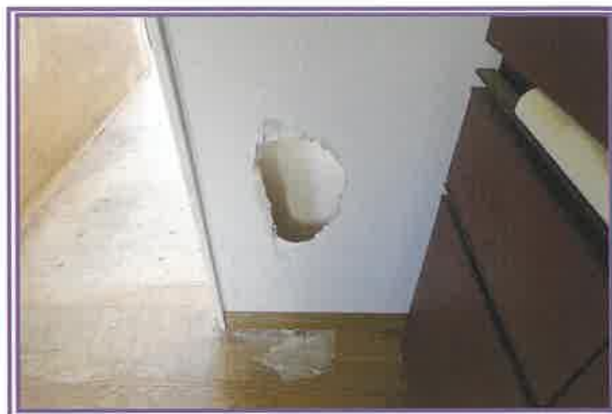
事務所の壁に穴が開いている状況を撮影したもの(物件2)
