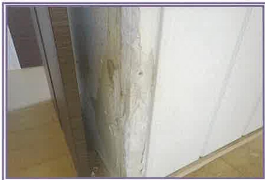
リビングダイニングの、壁の損傷箇所を撮影したもの(物件3)
