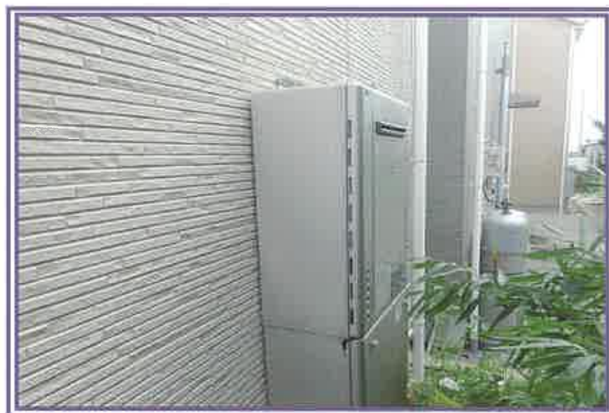
高効率ガス給湯設備及びその周辺を撮影したもの
