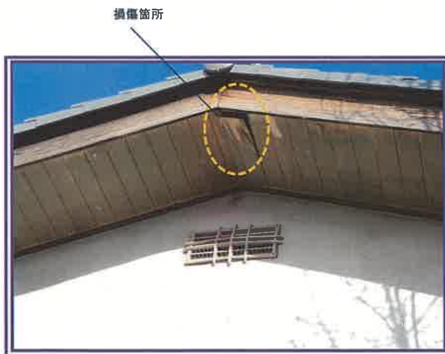
軒天の損傷箇所を撮影したもの
