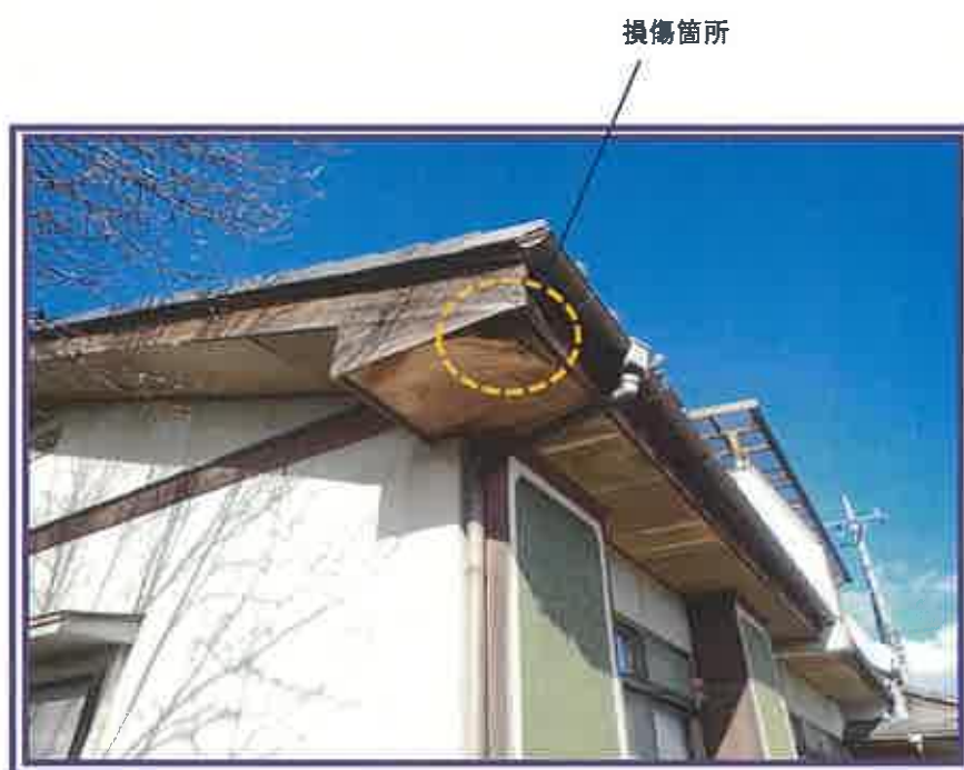
軒天の損傷箇所を撮影したもの
