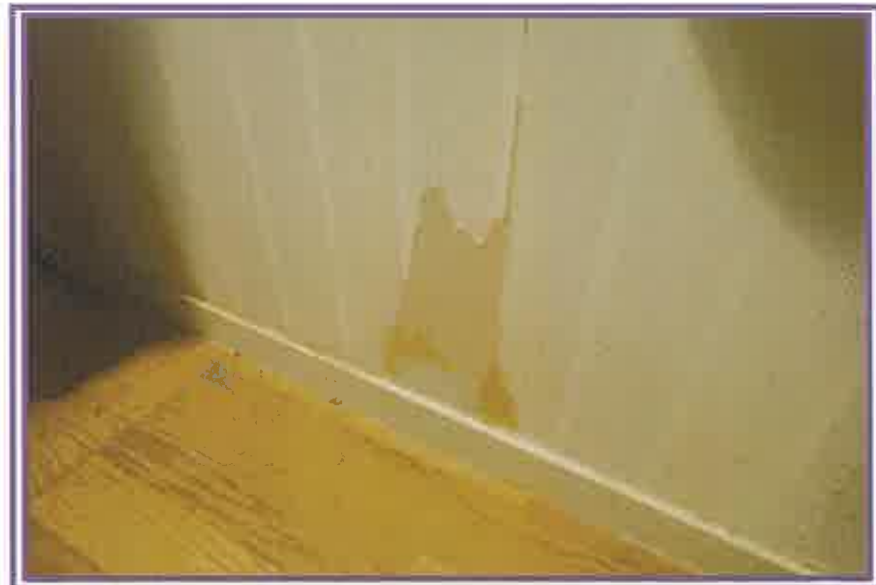
クロスの損傷箇所を撮影したもの(廊下の壁)12
