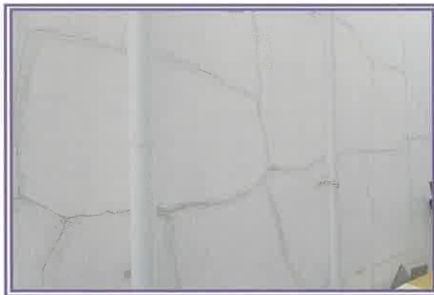
本件建物の壁に、クラック(ひび割れ)が認められる状況を撮影したもの
