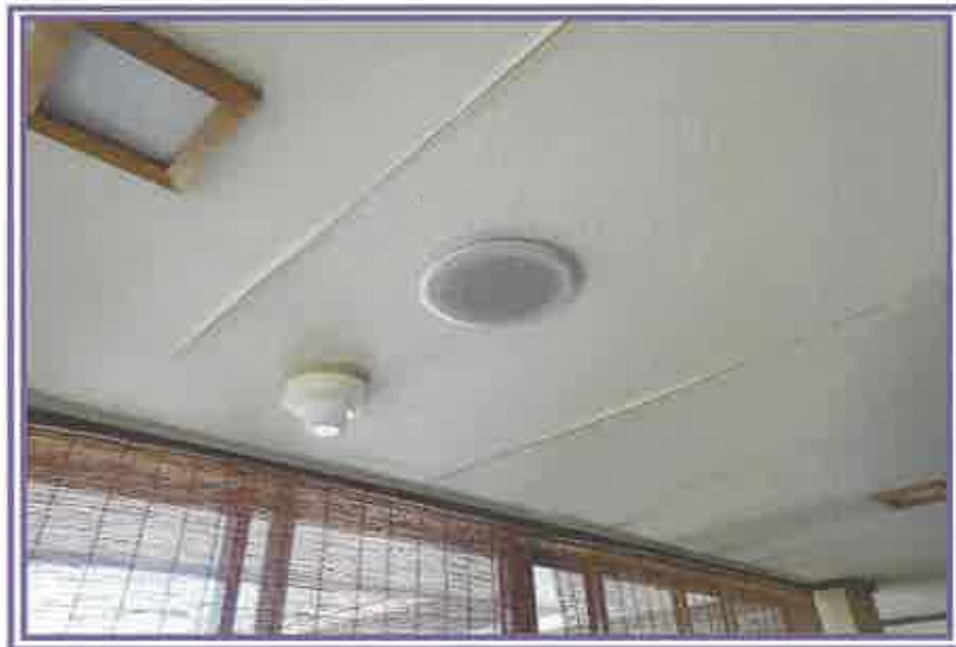
天井のクロスに損傷が認められる状況を撮影したもの(2階廊下)
