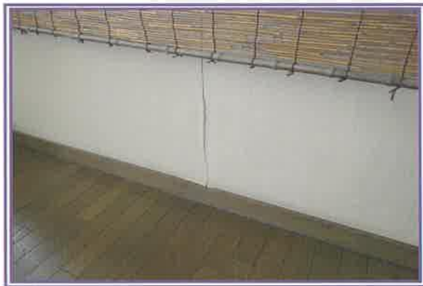
壁のクロスに損傷が認められる状況を撮影したもの(2階廊下)
