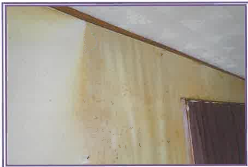
洋室(物件2附属建物符号2)の壁紙の汚れを撮影したもの
