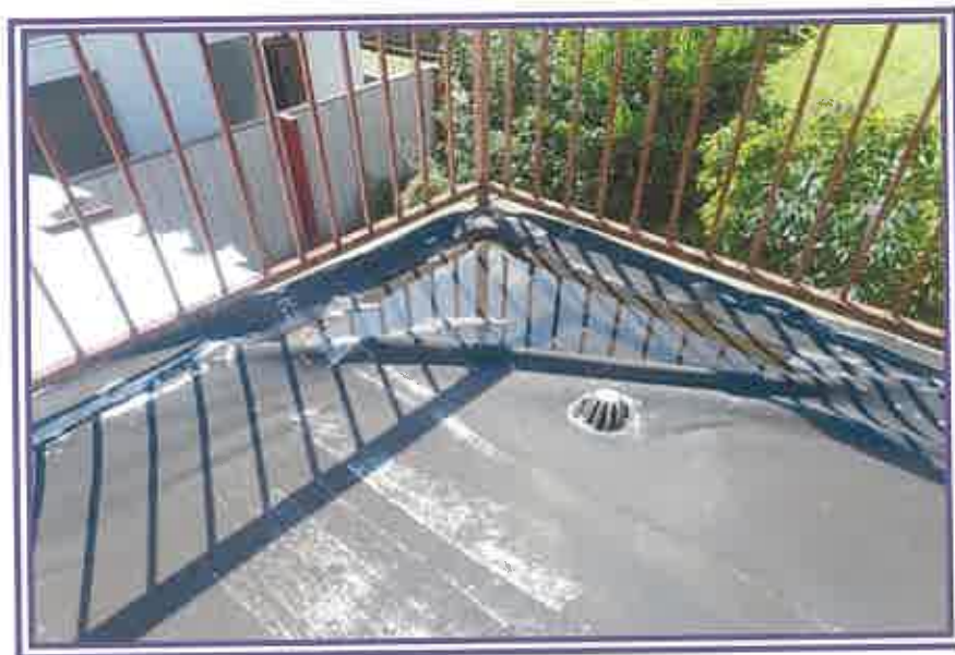
防水シート上に、水が溜まっている状況を撮影したもの(屋上)
