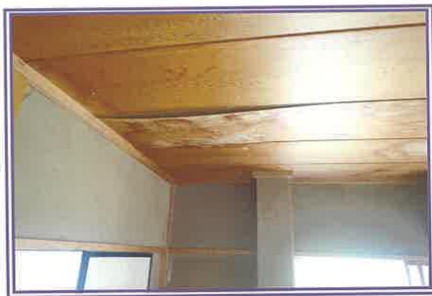
雨漏りによるものと推察される、天井の変形箇所を撮影したもの(和室5)
