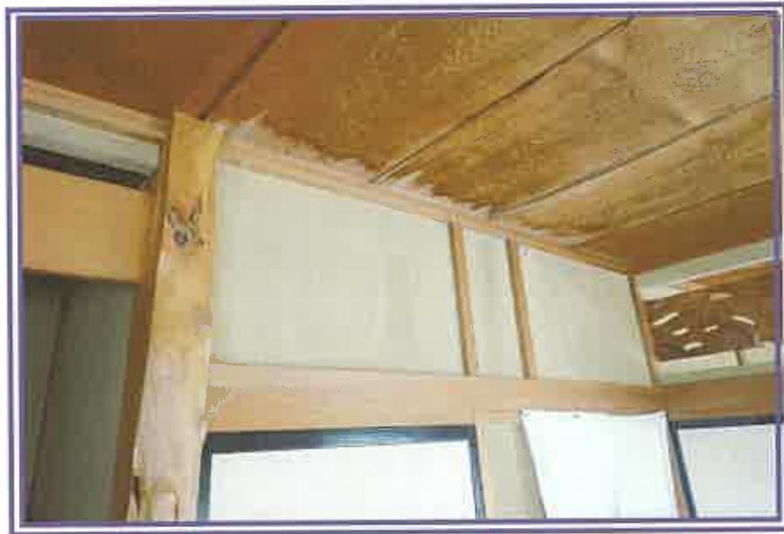
雨染みや雨漏り跡を撮影したもの(和室2)
