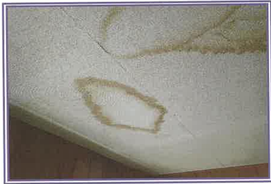
雨染みを撮影したもの(階段2階の天井)
