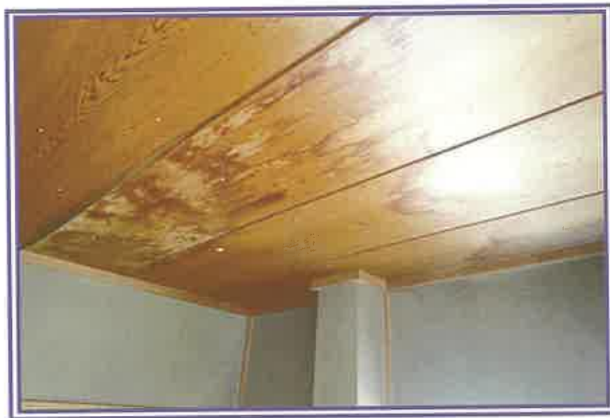
雨染みや雨漏り跡を撮影したもの(和室5)
