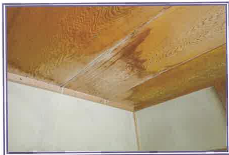
雨染みや雨漏り跡を撮影したもの(和室3)
