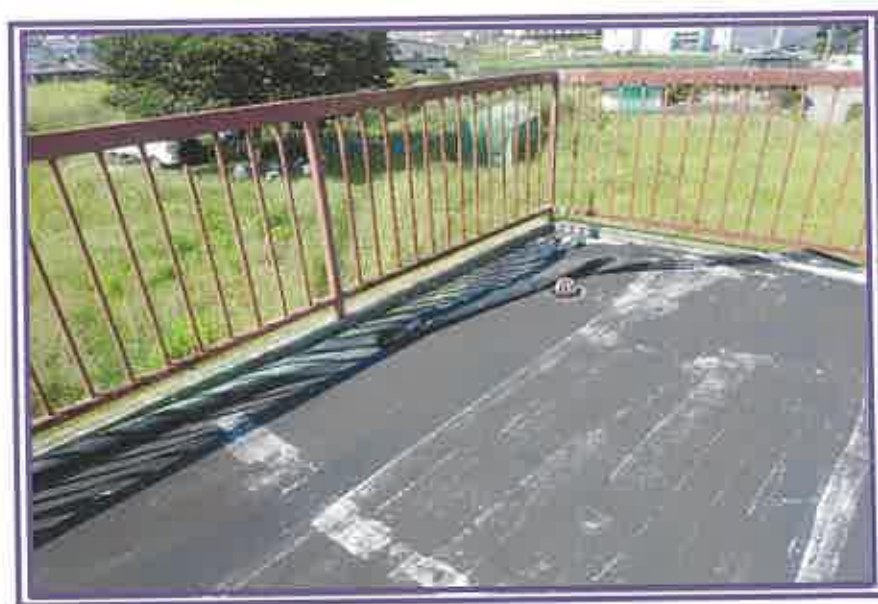
防水シートが、一部剥がれている状況を撮影したもの(屋上)
