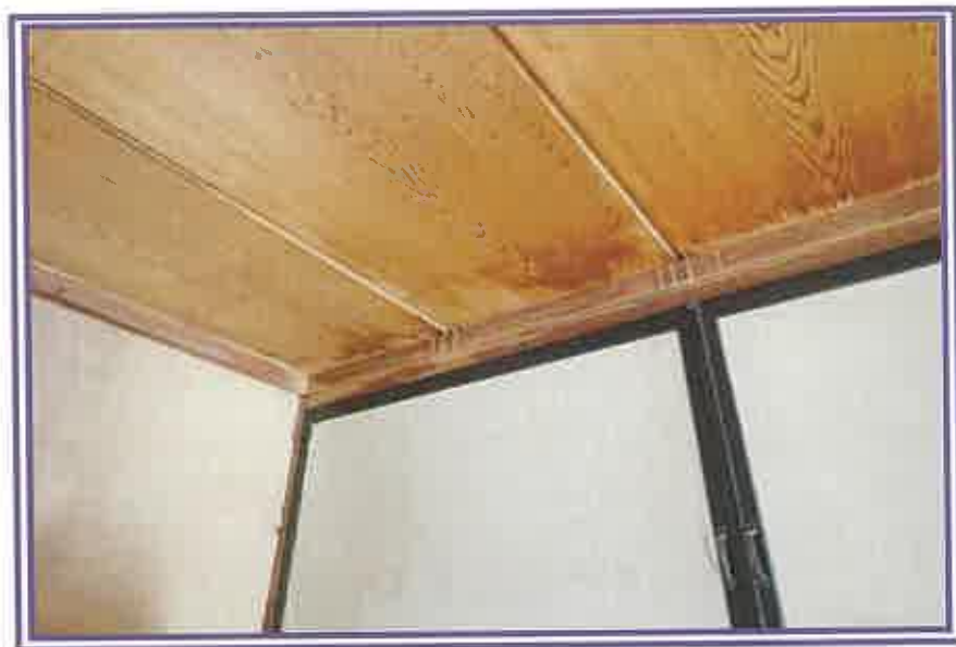
雨漏り跡を撮影したもの(和室6)
