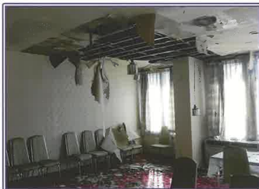
3階 会議室（天井の損傷状況）
