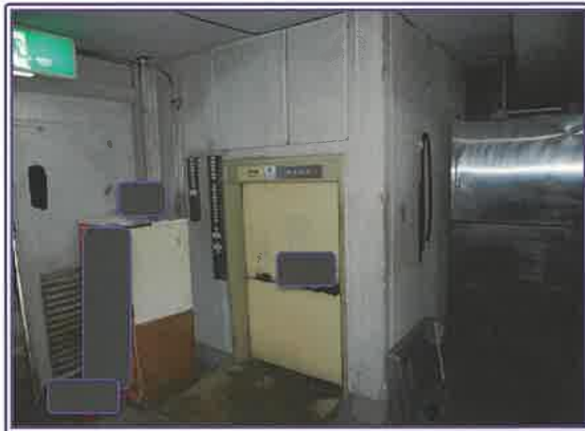
地下1階 配膳用エレベーター
