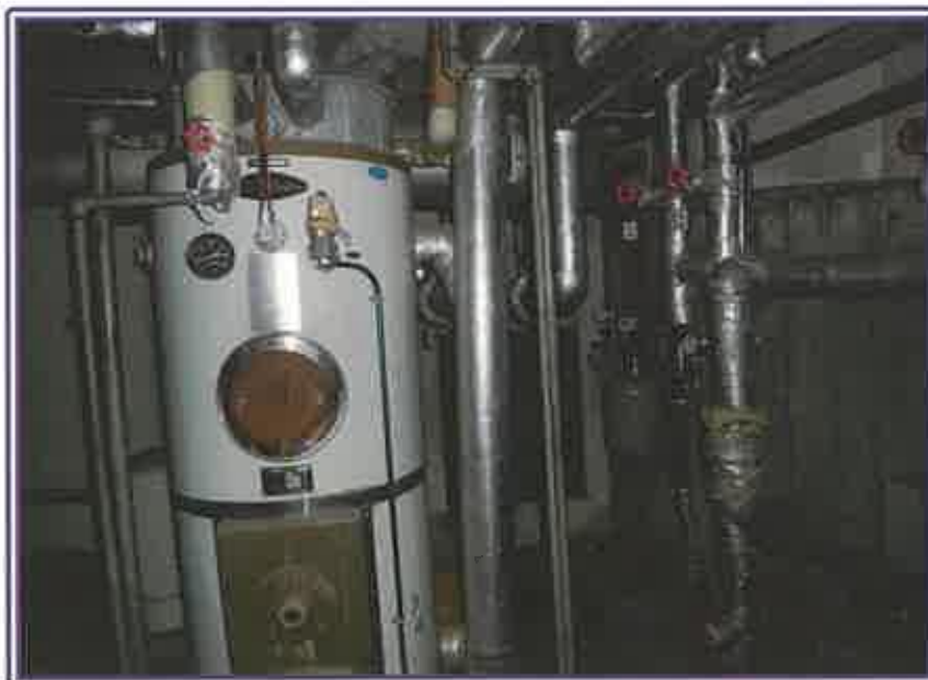
地下1階 少量危険物貯蔵取扱所（ボイラー庫）
