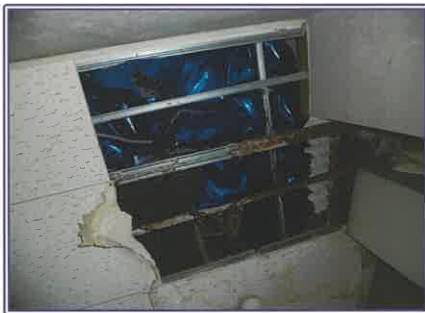
3階 操作室（天井の損傷状況）
