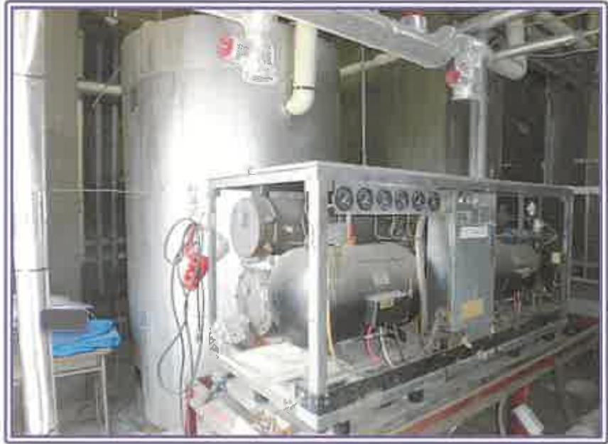
6階 東側機械室（物件5・主たる建物（旅館））
