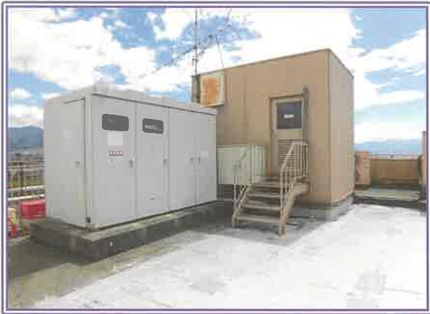
6階 西側機械室（右側の建物・左側は変電設備）（物件5・主たる建物（旅館））
