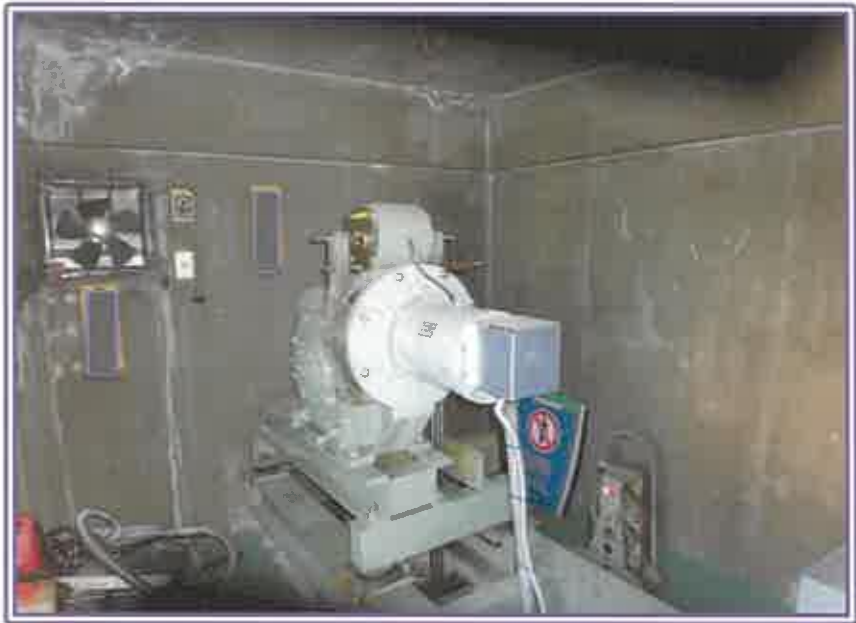
6階 西側機械室（物件5・主たる建物（旅館））
