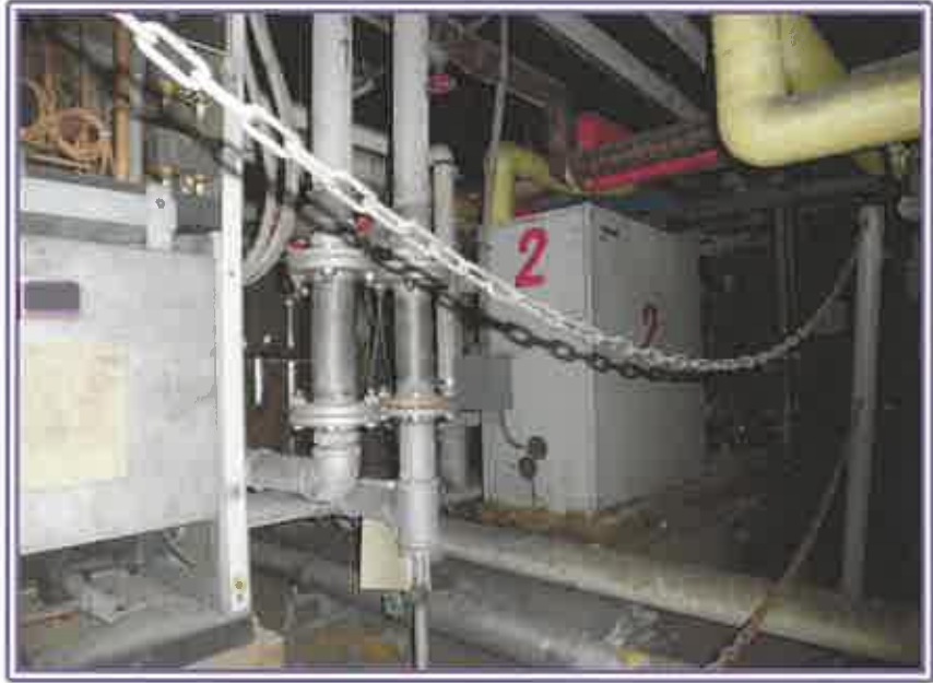
7階 機械室（物件5・主たる建物（旅館））
