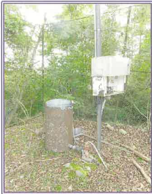
南西隅の地下水汲上ポンプ
