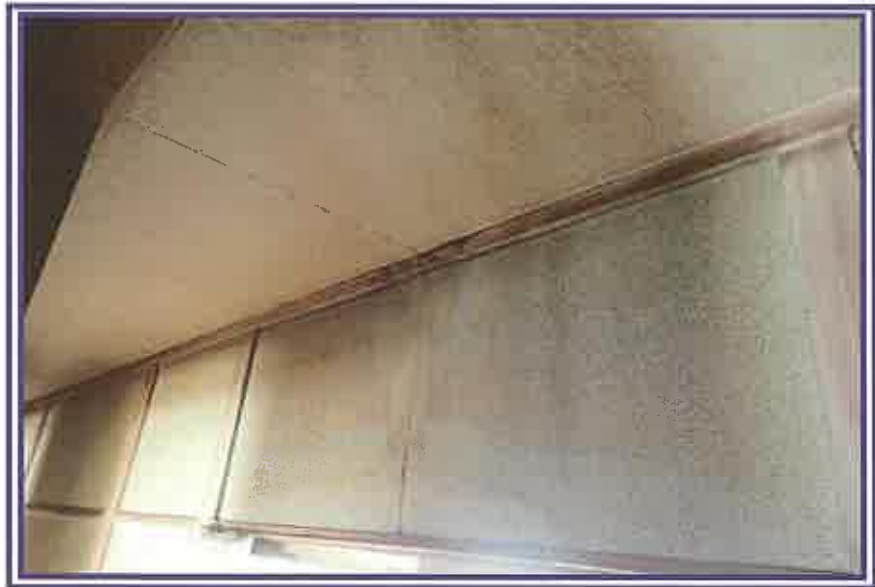
壁に損傷(亀裂)及び雨漏り跡が認められる状況を撮影したもの (1階階段付近の廊下)
