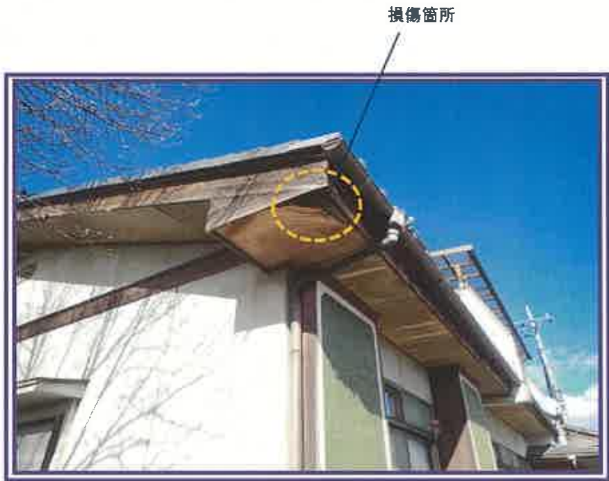
軒天の損傷箇所を撮影したもの
