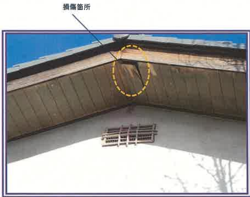
軒天の損傷箇所を撮影したもの
