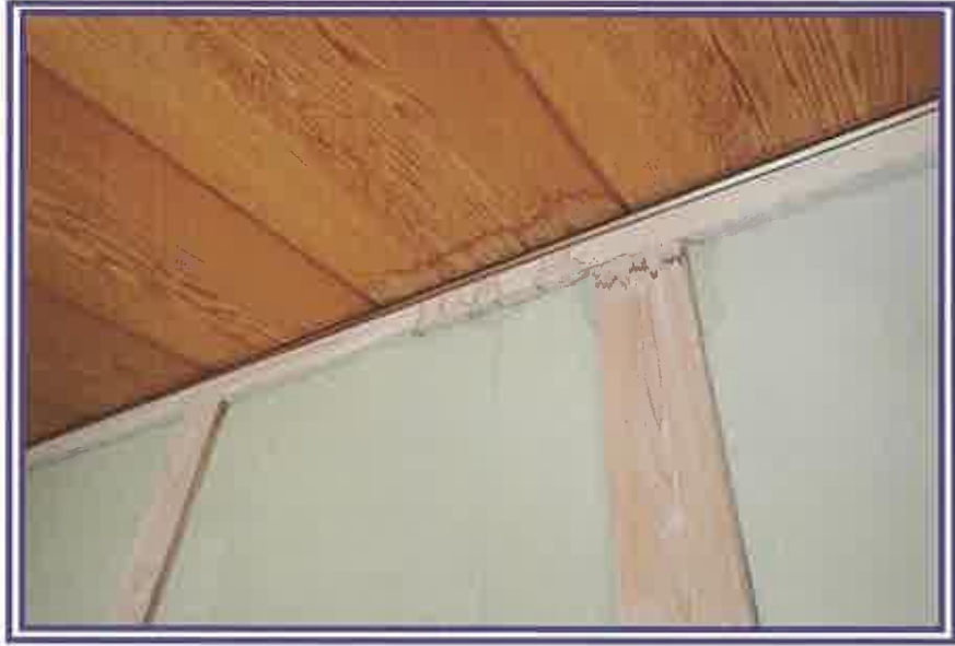
雨漏り跡が認められる状況を撮影したもの(和室3)
