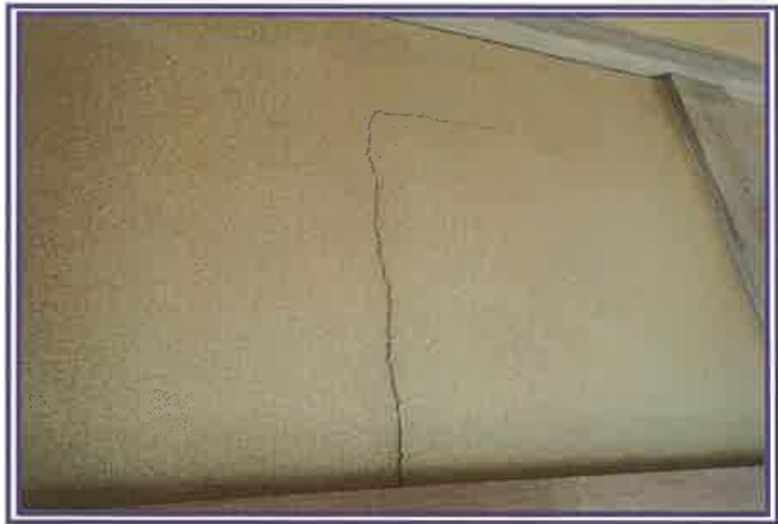
壁に損傷(亀裂)が認められる状況を撮影したもの(和室6)
