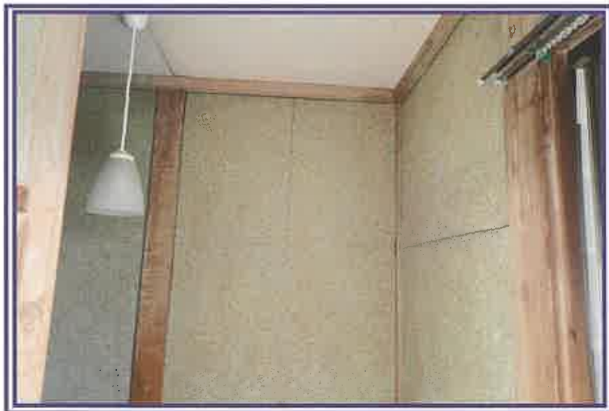
壁に損傷(亀裂)が認められる状況を撮影したもの(2階階段付近の廊下)
