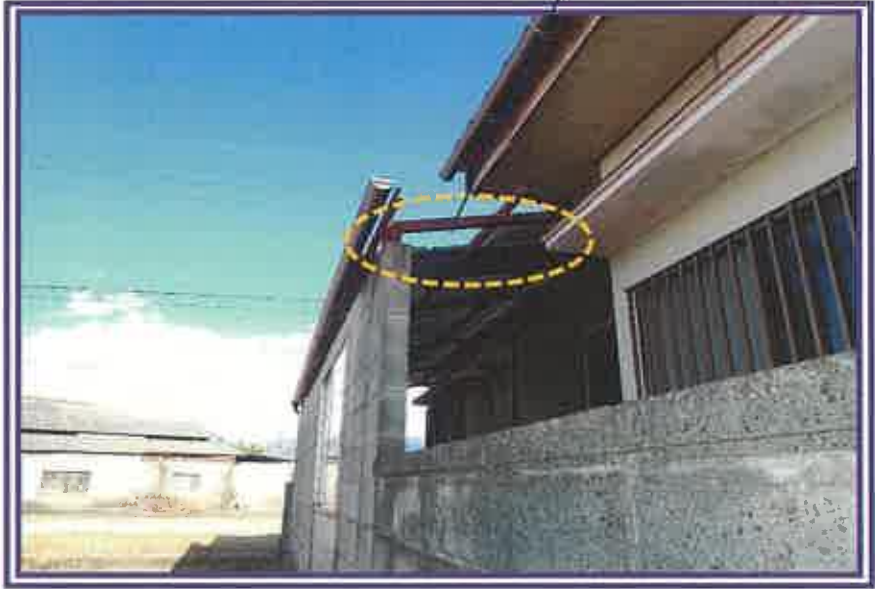
下屋の損傷箇所を撮影したもの
