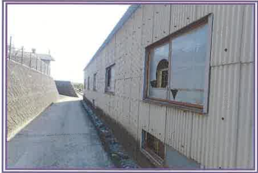
本件建物の窓ガラス(一部)が破損している状況を撮影したもの
