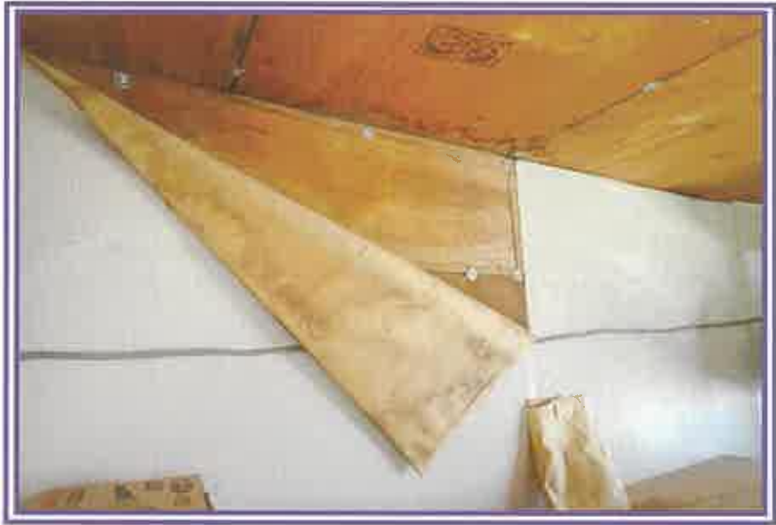
雨染みやクロス剥離が認められる状況を撮影したもの(事務室)
