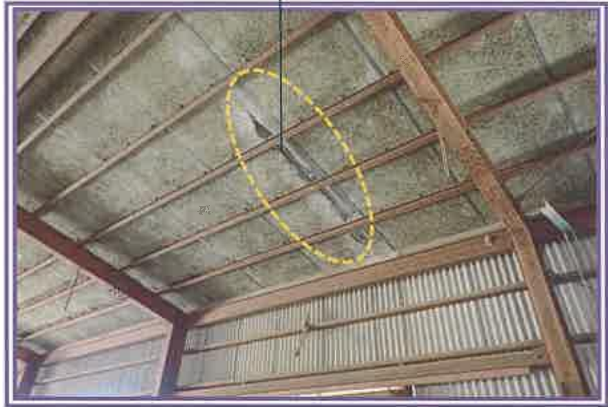
天井材の損傷が認められる状況を撮影したもの
