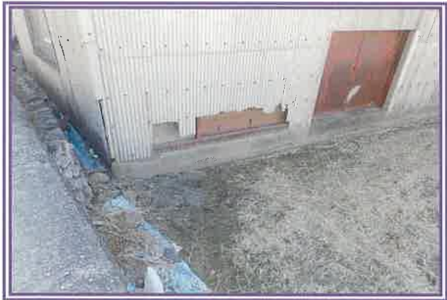
本件建物の壁に損傷が認められる状況を撮影したもの
