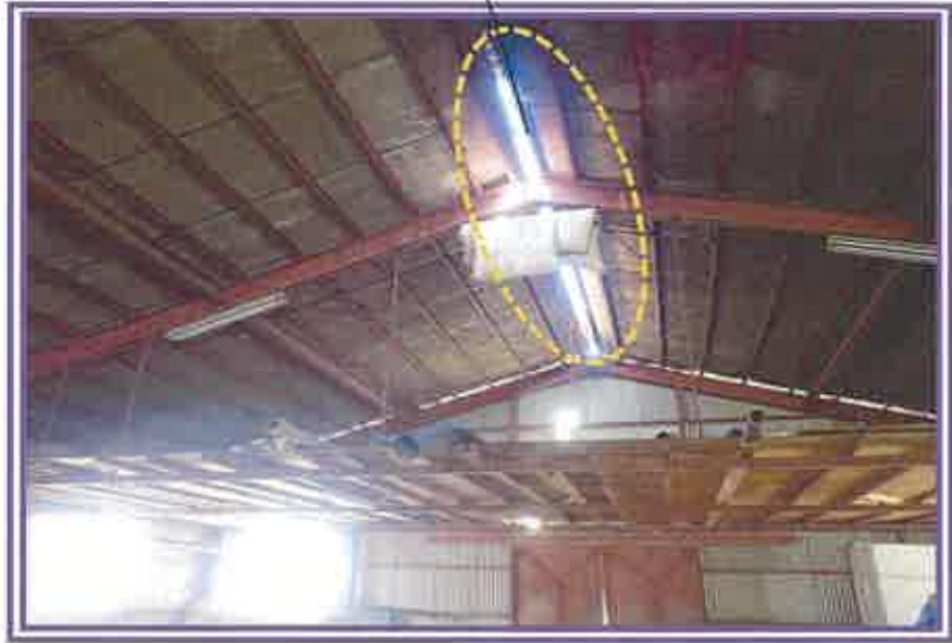
屋根(一部)が欠落し、雨漏りする箇所及びその周辺を撮影したもの
