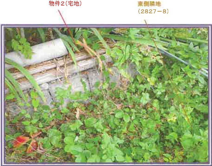
物件2の土地と東側隣地(地番2827番8)との境界付近に、コンクリート製のブロックが積まれている状況を撮影したもの
