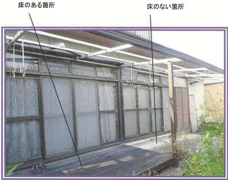
本件建物に設置されている下屋(テラス様のもの)及びその周辺を撮影したもの
