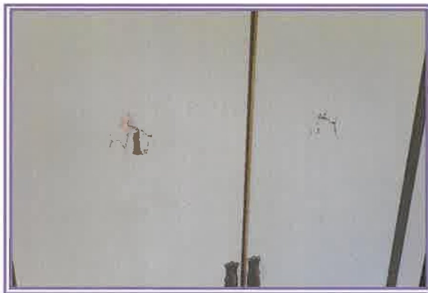
物入の扉に損傷が認められる状況を撮影したもの(洋室3)
