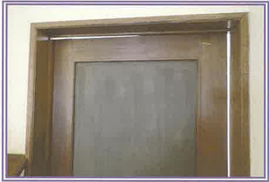
ドアを閉じて壁との間に隙間が認められる状況を撮影したもの(洋室3)
