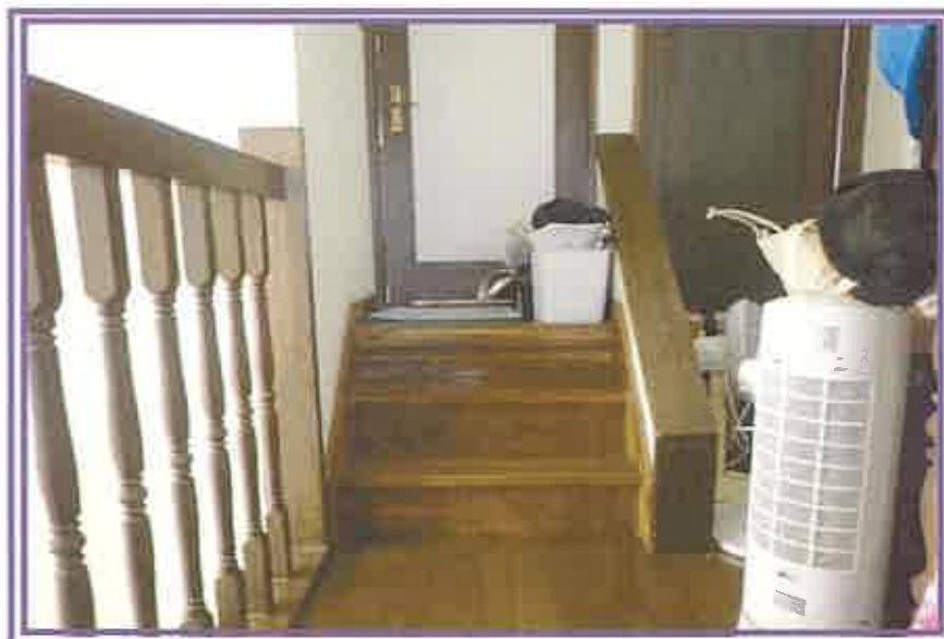
2階廊下と洋室4の間に、段差があることを撮影したもの
