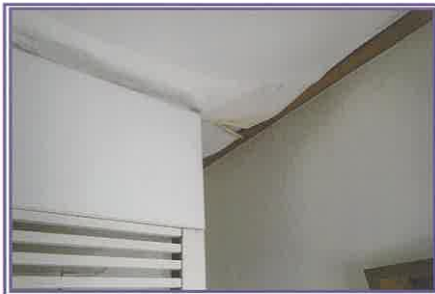
キッチン(増築部分)の天井クロスが剥離している状況を撮影したもの
