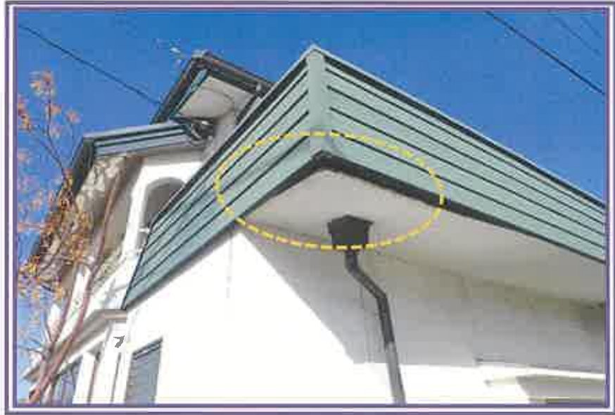
本件建物(南東側部分)の軒天に、損傷が認められる状況を撮影したもの
