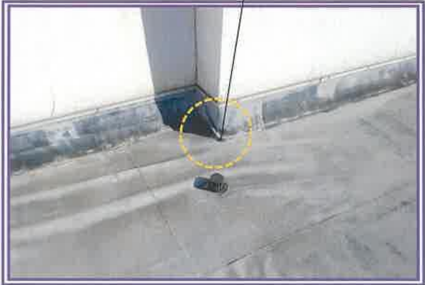
防水シートに歪みや損傷が認められる状況を撮影したもの
