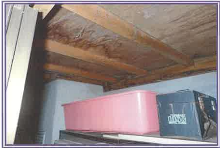
車庫奥の物入天井に、雨漏り跡が認められる状況を撮影したもの
