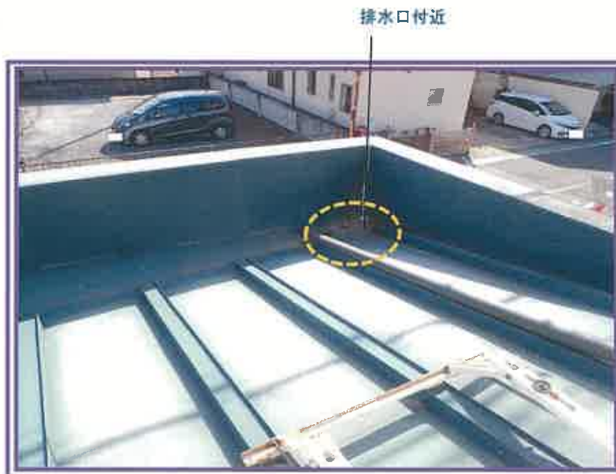
排水口付近に落葉が堆積していたところに雨が降った際、プールのような旨 関係人が述べていた箇所(キッチン付近の屋根)を撮影したもの
