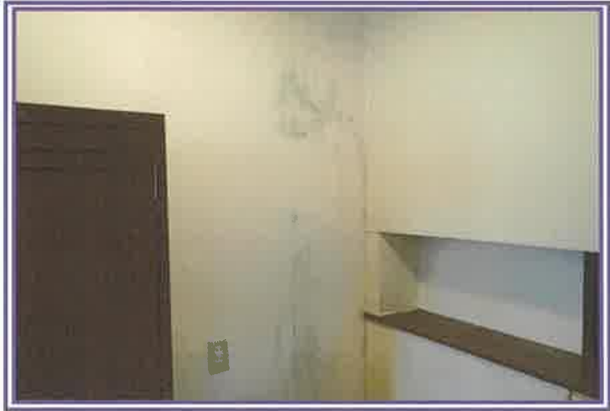
洋室1の壁のクロスに、カビ様の汚れが認められる状況を撮影したもの
