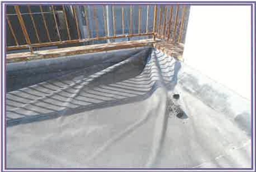
防水シートに歪みが認められる状況を撮影したもの
