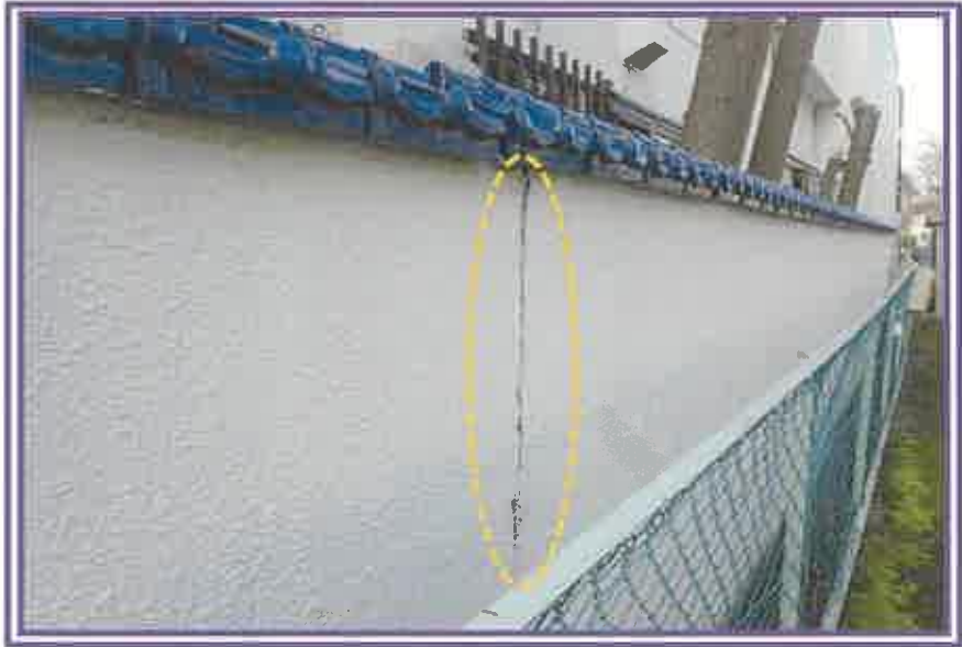
本物件敷地内の塀に亀裂が入っている状況を撮影したもの
