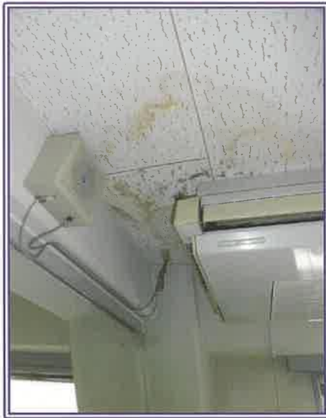
雨漏り跡（シミ）
