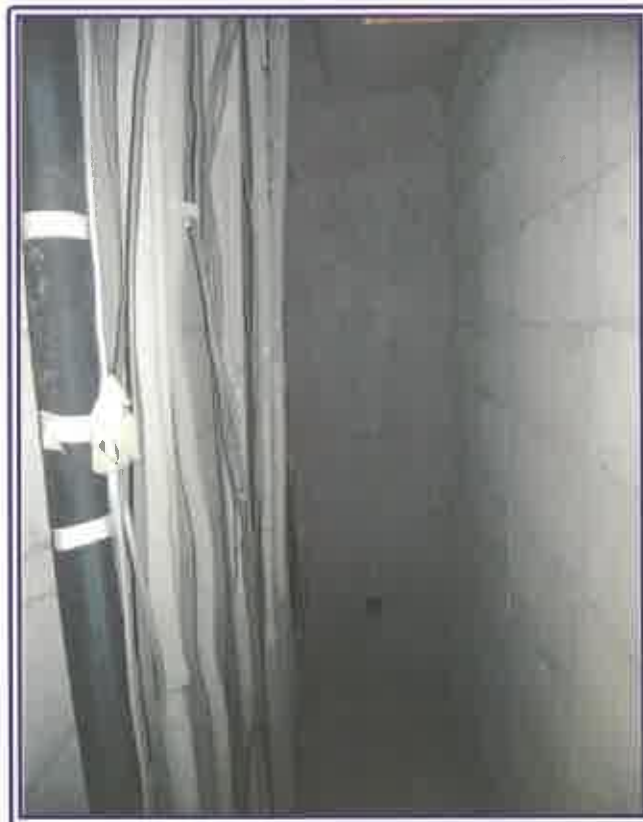
パイプスペース
