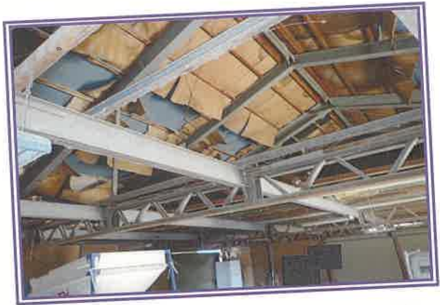
物件5(倉庫)の天井材の剥離や損傷が認められる状況を撮影したもの
