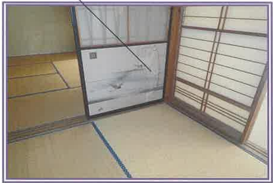
襖に汚れが認められる状況を撮影したもの(和室8)
