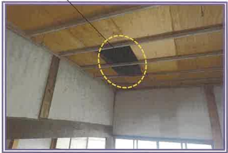
天井材に損傷が認められる状況を撮影したもの(和室6)
