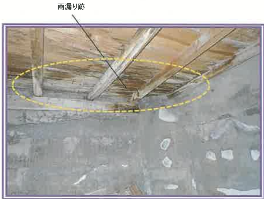
雨漏り跡及びその周辺を撮影したもの(物置1)
