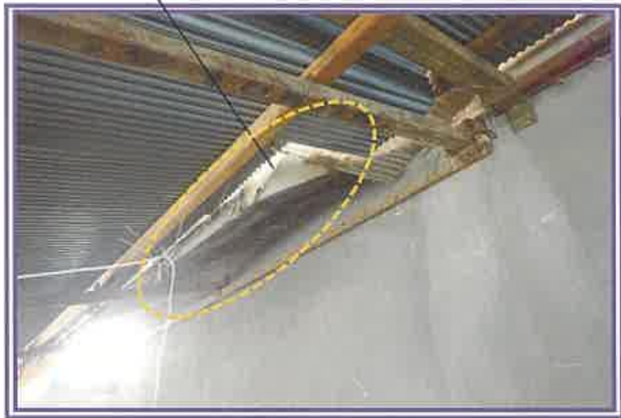
屋根の接合部付近の雨漏り箇所を撮影したもの(物置2)
