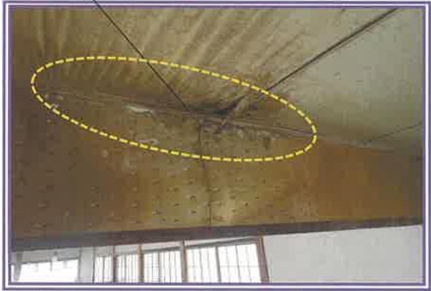
天井に雨漏り跡が認められる状況を撮影したもの(和室6)
