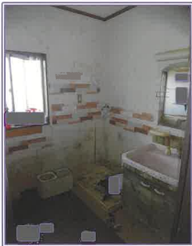
1階 脱衣・洗面・洗濯室 ※ カビ汚れが甚だしい
