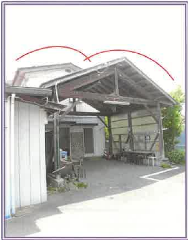
物件2の建物のうち 奥の居宅部分の近景 ※ 手前は雨除（構築物）
