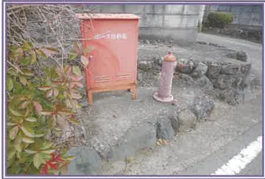
物件1の土地上にホース格納庫及び消火栓が設置されている状況を撮影したもの
