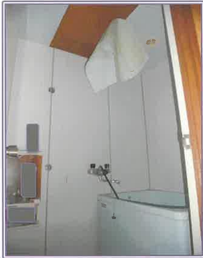
浴室（天井材の剥離あり）
