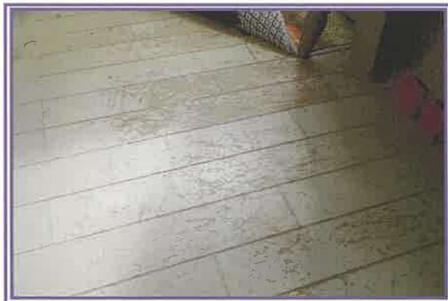
リビングの床に、引っ掻き傷が認められる状況を撮影したもの
