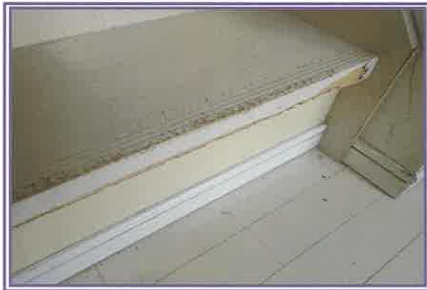
1階付近の階段に、引っ掻き傷が認められる状況を撮影したもの
