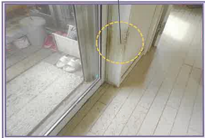
1階廊下の柱や床に、引っ掻き傷が認められる状況を撮影したもの
