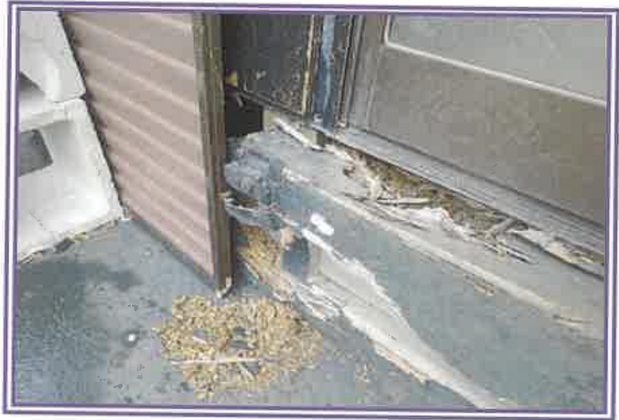
本件建物の土台付近が腐食している状況を撮影したもの
