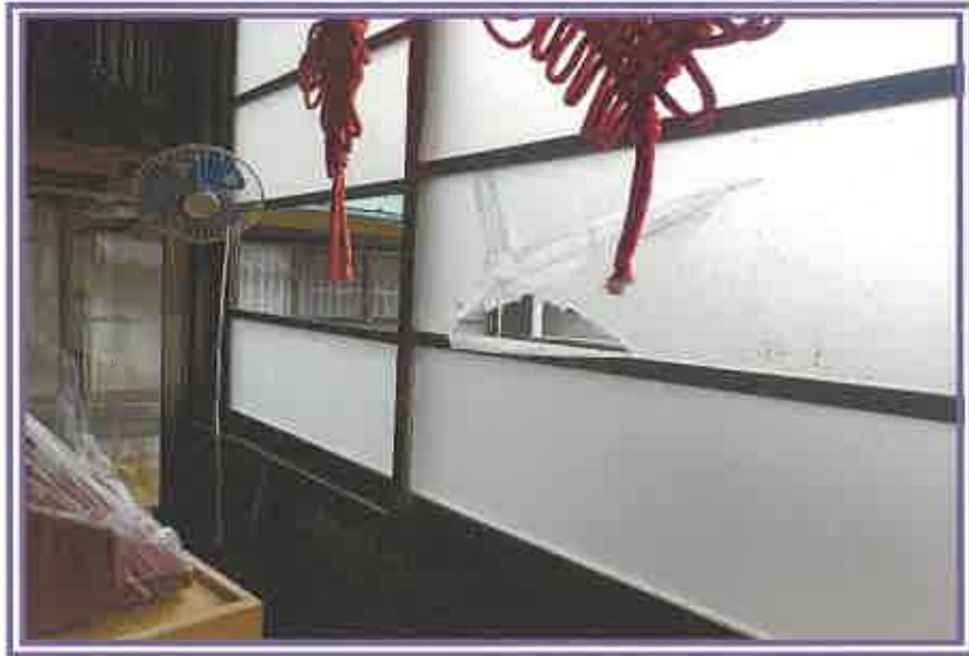
窓ガラスの破損・欠損が認められる状況を撮影したもの(物件2未登記附属建物1(物置))
