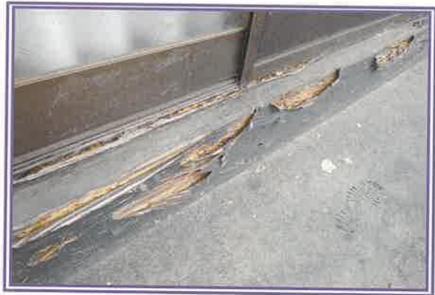
本件建物の土台付近が腐食している状況を撮影したもの
