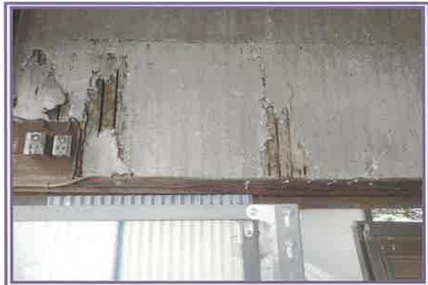
壁の保護材に損傷が認められる状況を撮影したもの(物件2未登記附属建物1(物置))
