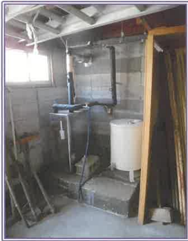
1階 石油給湯機置場
