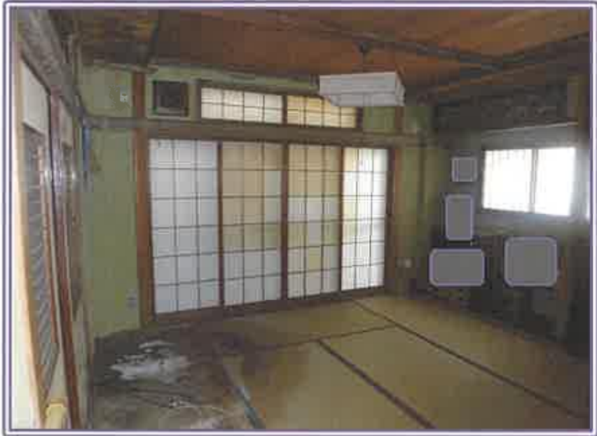
2階和室（居宅内） ※ 左側の畳に 雨漏りによるカビ汚れあり
