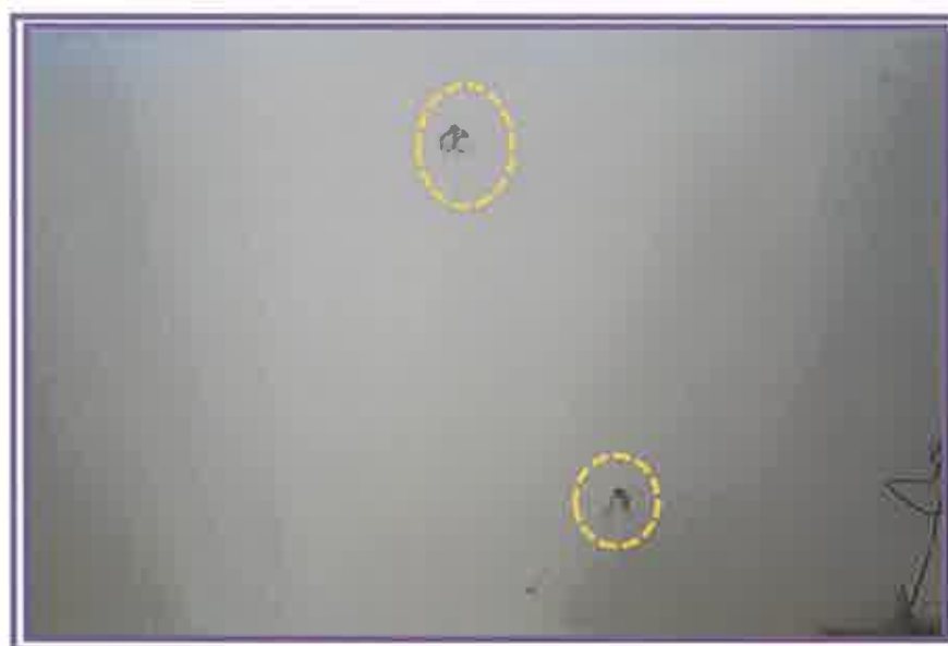
壁に穴が開いている状況を撮影したもの(玄関付近)
