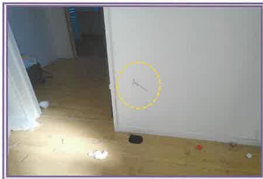
壁に穴が開いている状況を撮影したもの(キッチン付近)
