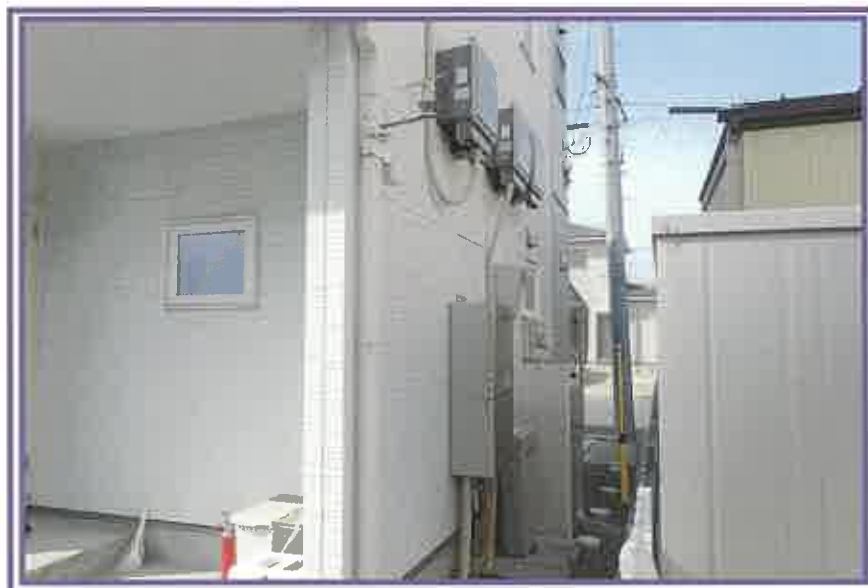
パワーコンディショナーが設置されている状況を撮影したもの
