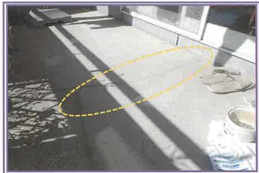
ベランダの床にクラックが認められる状況を撮影したもの
