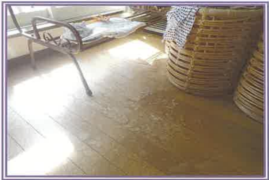
床材に色褪せが認められる状況を撮影したもの(洋室1)
