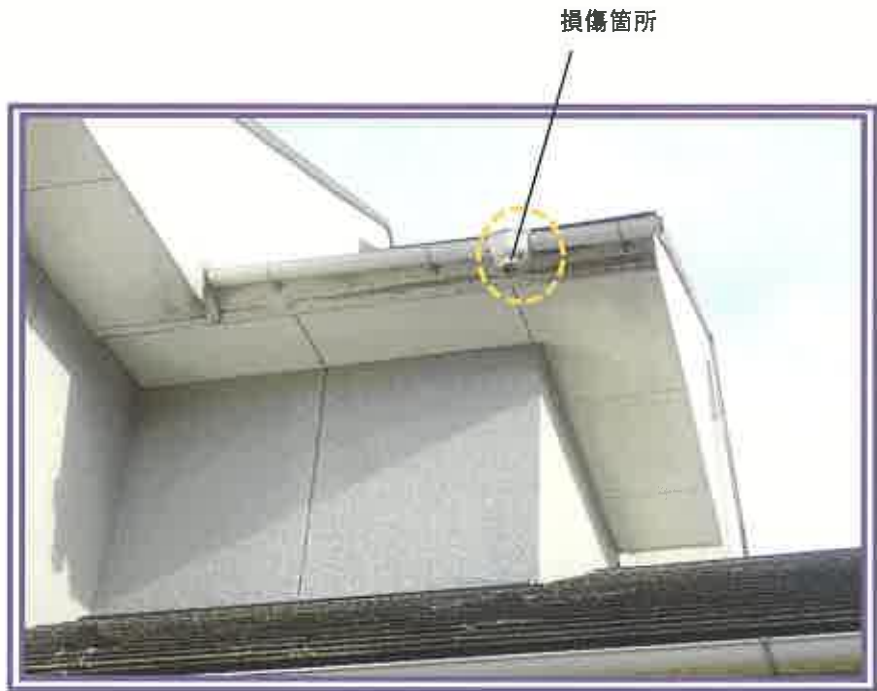
雨樋のうち、集水器より下部が欠落している状況を撮影したもの
