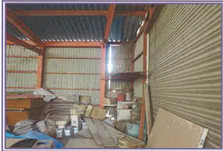
外壁に隙間が認められる状況を撮影したもの(物件13(工場))
