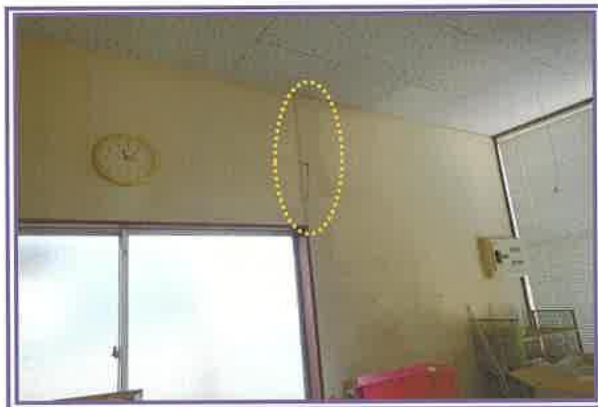
事務室3の壁のクロスに損傷が認められる状況を撮影したもの (物件13附属建物符号1(事務所))
