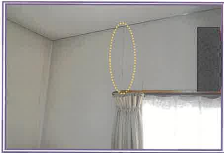
洋室2の壁のクロスに損傷が認められる状況を撮影したもの(物件12(居宅))
