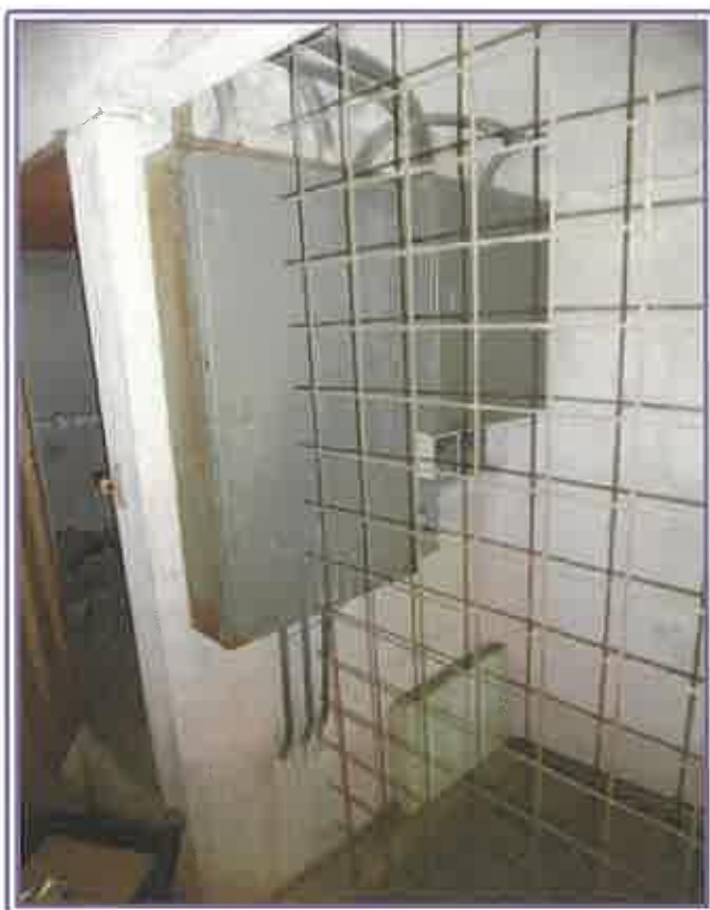
1階 配电箱（車庫脇）
