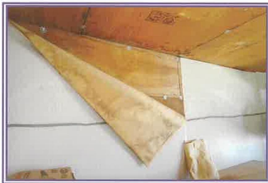
雨染みやクロスの剥離が認められる状況を撮影したもの(事務室)
