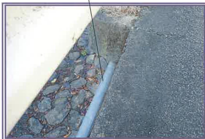
源泉供給用の配管及びその周辺を撮影したもの (旧館と新館の間を流れる水路付近)
