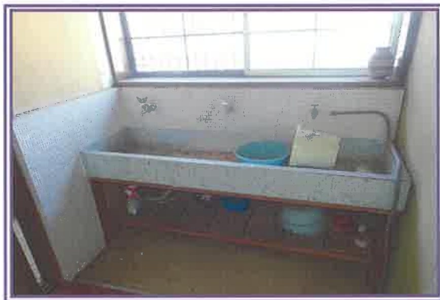
2階洗面台 (物件7居宅, 浴場)
