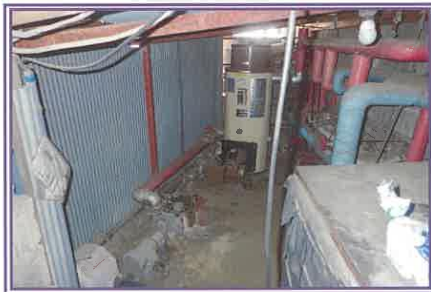
ボイラー室 (物件7居宅, 浴場)
