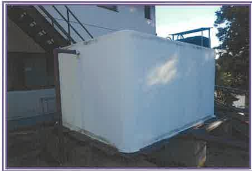
物件11旅館の2階屋上に設置されている給湯タンク
