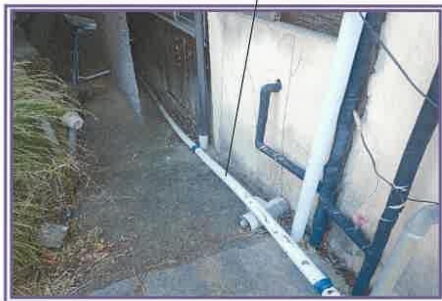
源泉供給用の配管及びその周辺を撮影したもの(旧館付近)
