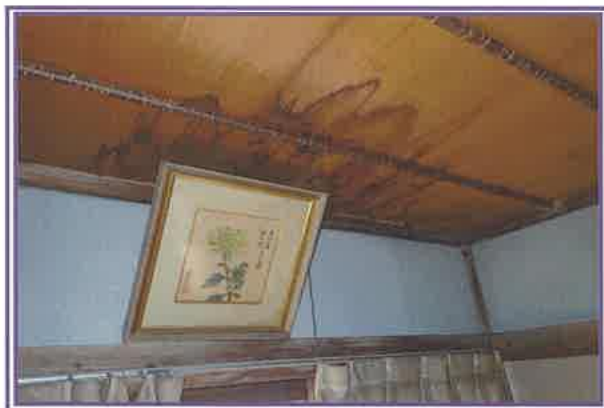
3階和室11の天井に、雨漏り跡が認められる状況を撮影したもの(物件7居宅, 浴場)
