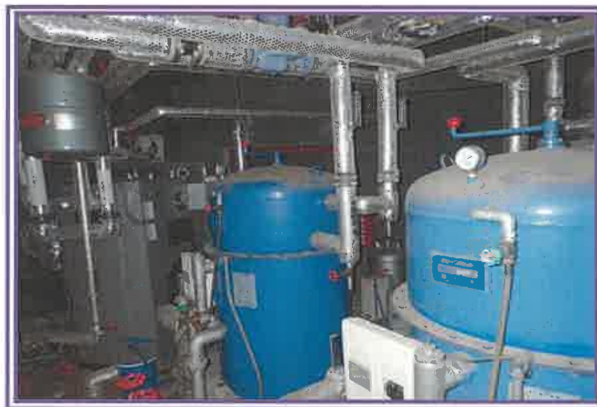
ボイラー室 (物件11旅館)
