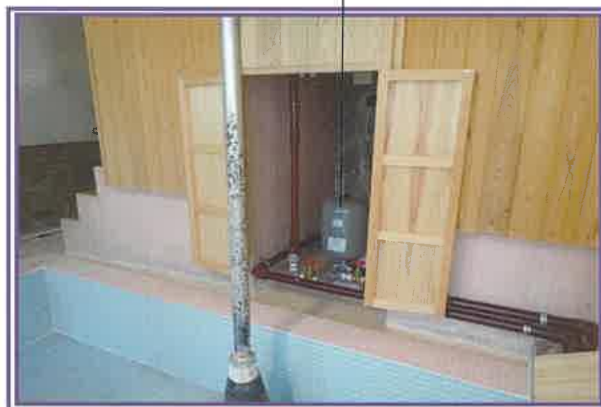
新館(物件11)へ源泉を供給するためのポンプを撮影したもの(旧館地下1階)
