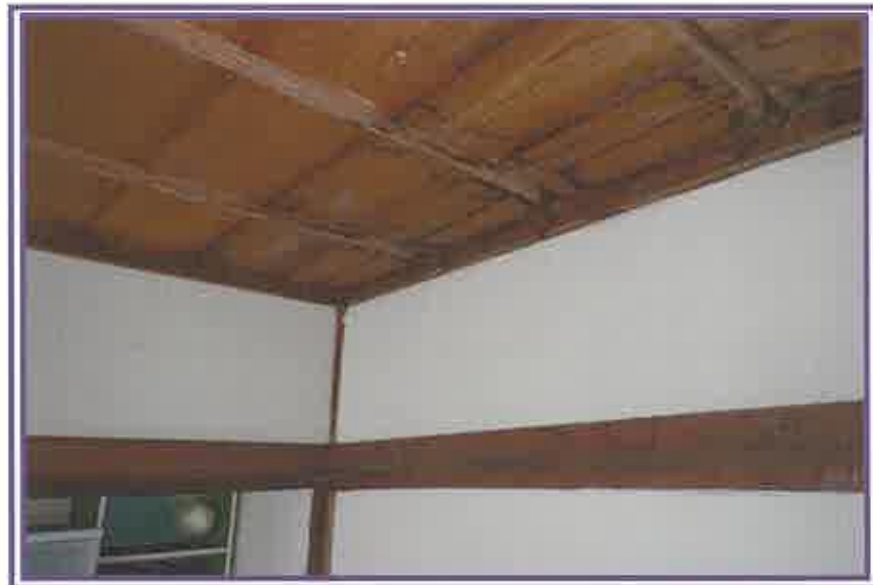
2階和室9の天井に、雨漏り跡が認められる状況を撮影したもの(物件7居宅, 浴場)
