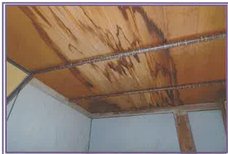
3階和室10の天井に、雨漏り跡が認められる状況を撮影したもの(物件7居宅, 浴場)
