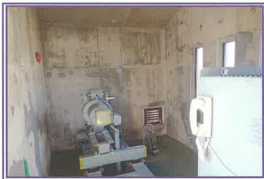
4階機械室 (物件11旅館)
