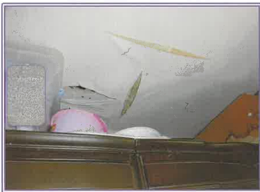
雨漏りによる損傷箇所
