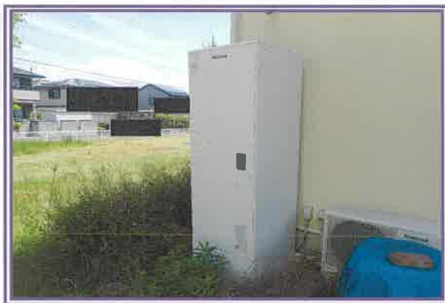
ヒートポンプ給湯設備
