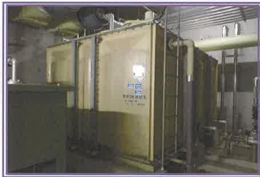
受水槽室内を撮影したもの
