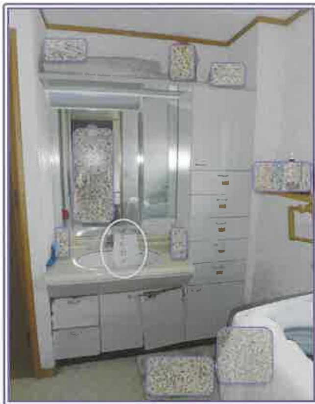
1階 脱衣・洗面・洗濯室（使用禁止の貼紙があるので水廻等に支障が生じた模様）
