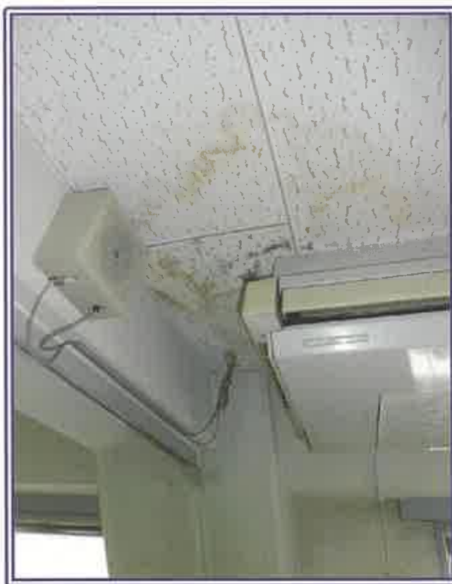
雨漏り跡（シミ）
