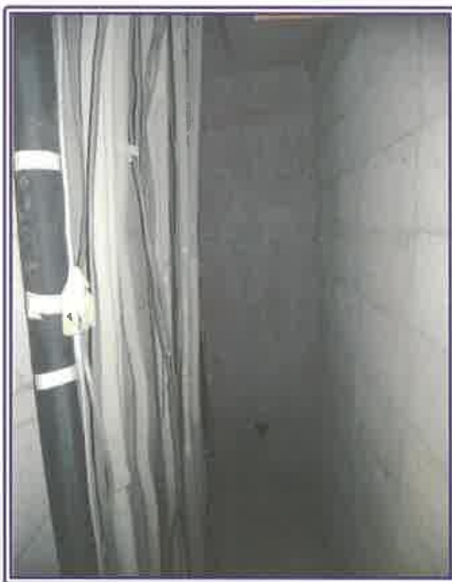
パイプスペース
