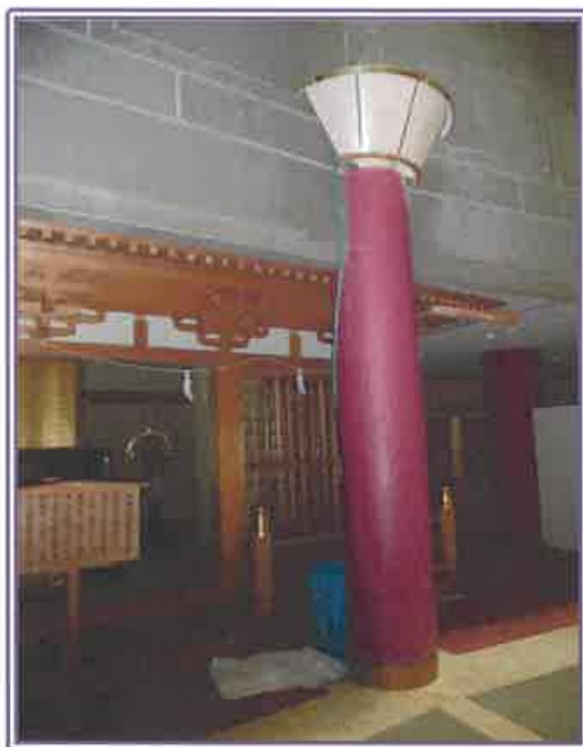
1階彫刻の間 脇の太柱（壁伝いに雨漏りが生じているためバケツや布巾が置かれている）
