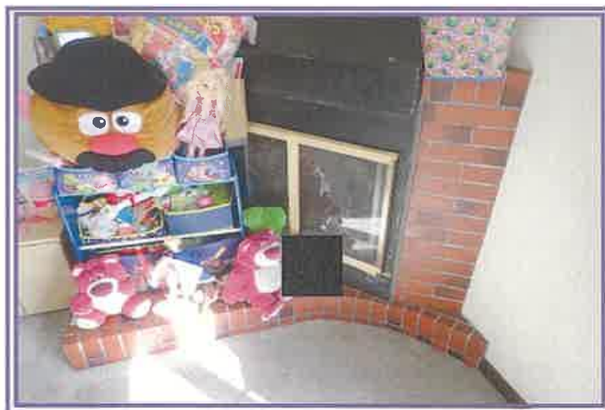
リビング内に設置されている暖炉
