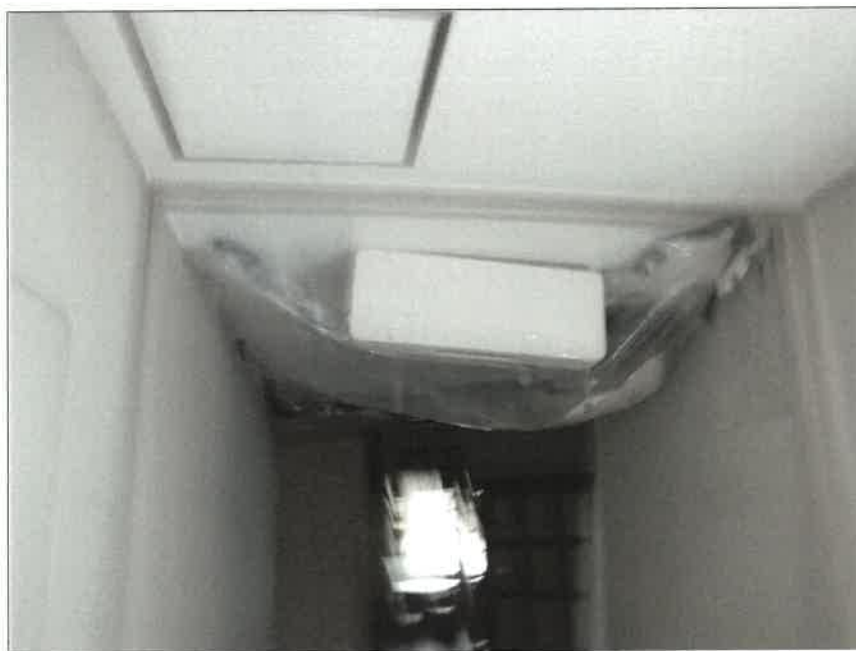
物件 6 と 7 の渡り廊下損傷部分
