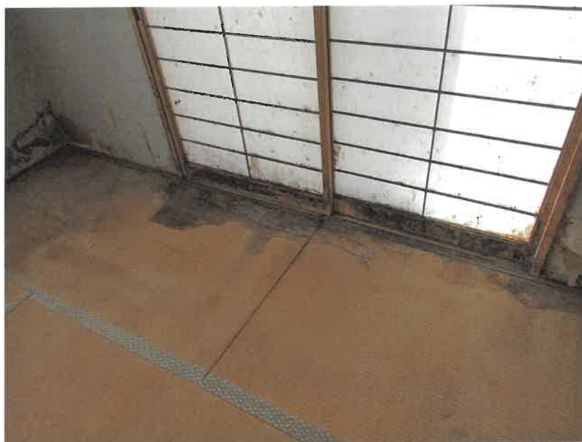
1階和室の床の状況（物件2）
