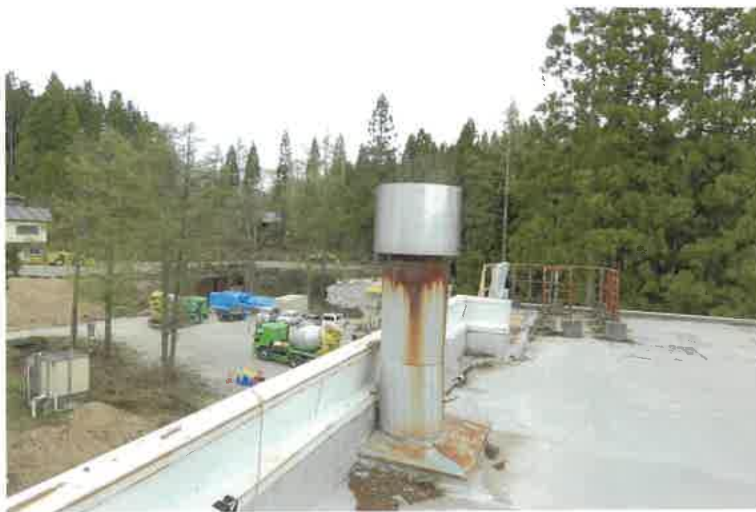
写真⑪（ボイラー排気口）
