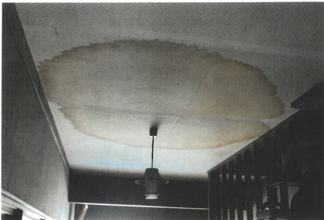
写真⑪（物件2の玄関付近1階天井）
