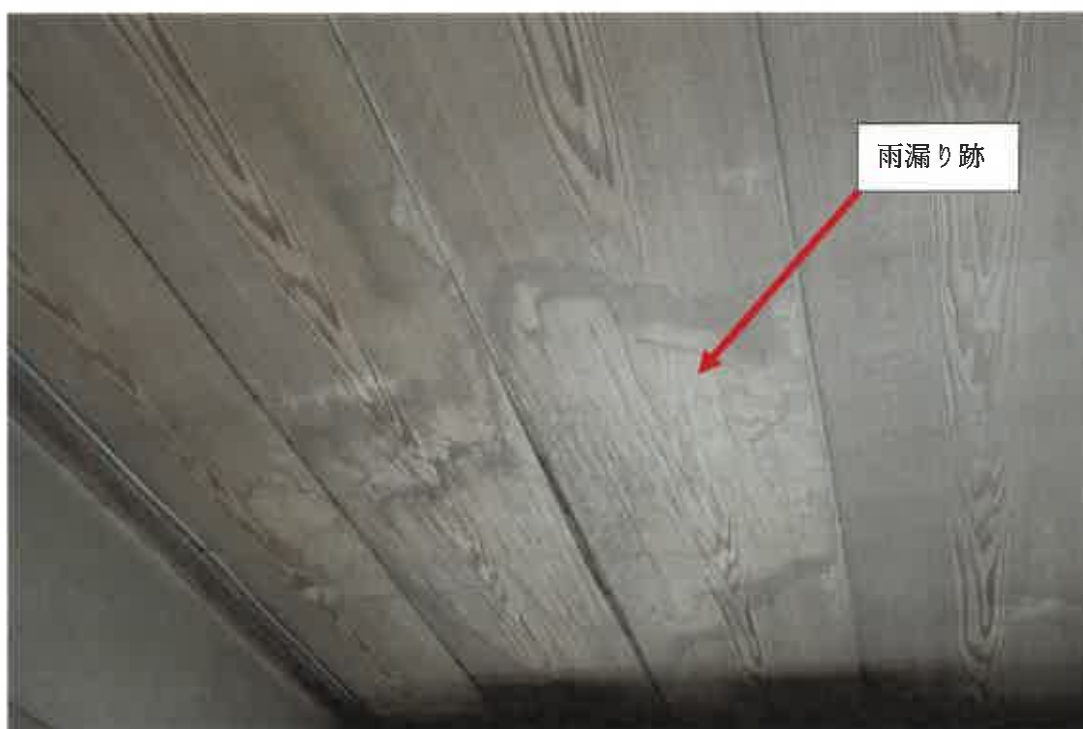
写真⑫（洋室天井・雨漏り跡）
