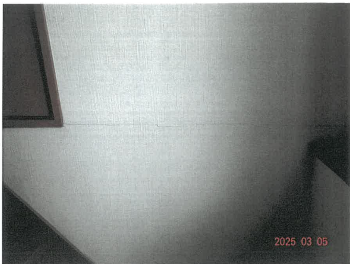
⑦ 2階へ上る階段の壁の亀裂
