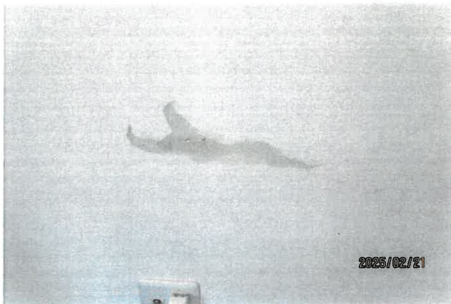
壁紙が剥離している状況
