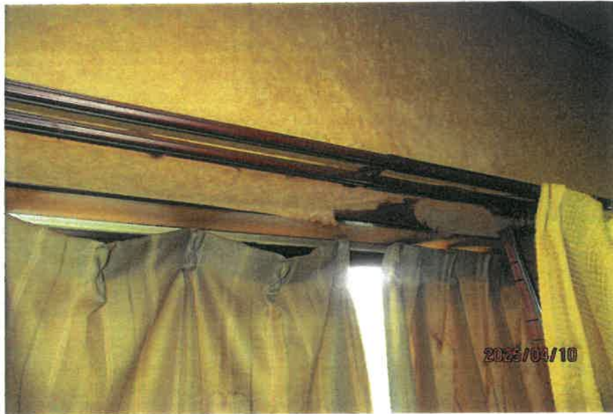
雨漏り跡の状況
