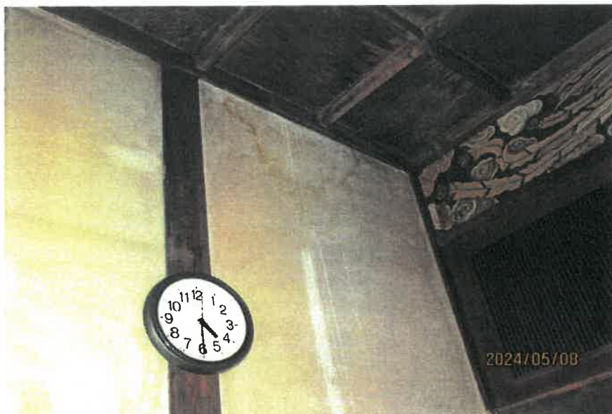
雨漏り跡の状況 染みの状況
